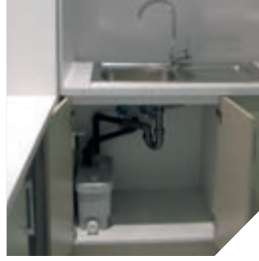
Mutfak dolabına yerleştirilmiş Sanispeed.
