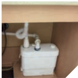
Mutfak eyesinin altına gizlenmiş Sanivite pompa
