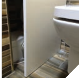
Lavabo altına gizlenmiş Saniflo
