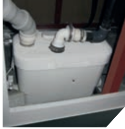
Alçıpan içine gizlenmiş Sanispeed pompa
